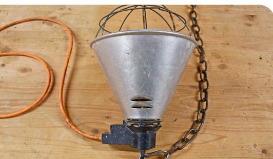
Vérifier régulièrement l'état de la lampe chauffante, de la chaîne et du point de fixation au plafond. (Photo : SPAA)
