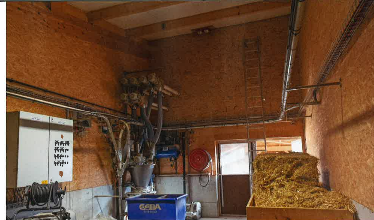
Der Löschposten befindet sich im mittleren Stall. Oben an der Decke sind zwei der Rauch- und Feuermelder zu sehen, die auf dem Betrieb getestet wurden.
